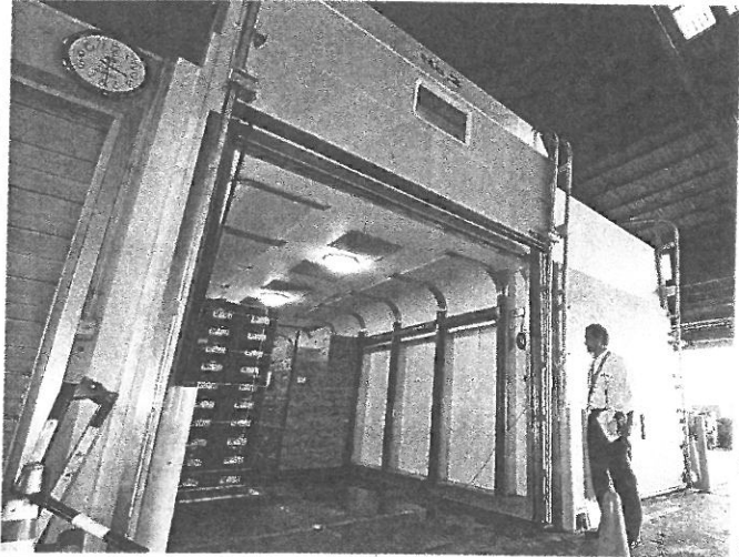
カラカグループが新設したバナナの追熟加工設備。倉敷地方卸売市場
